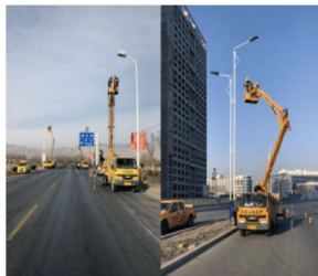
宁波 文创港智慧照明项目
