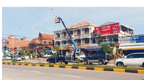
柬埔寨智慧照明控制项目
